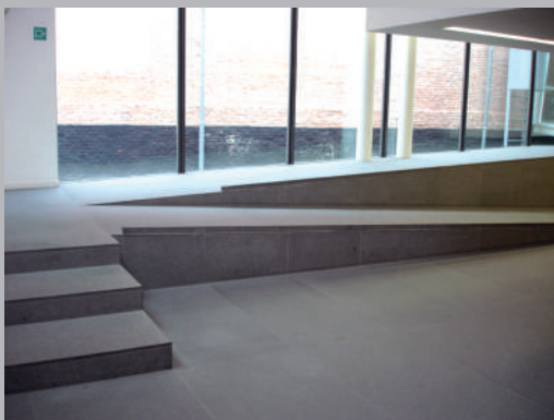
✘ Absence de mains-courantes de part et d'autre de la rampe (et de l'escalier)
