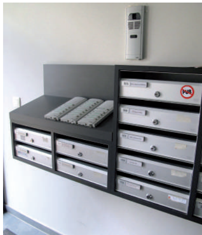
❌ Sonnettes disposées trop haut et trop à l'horizontale
